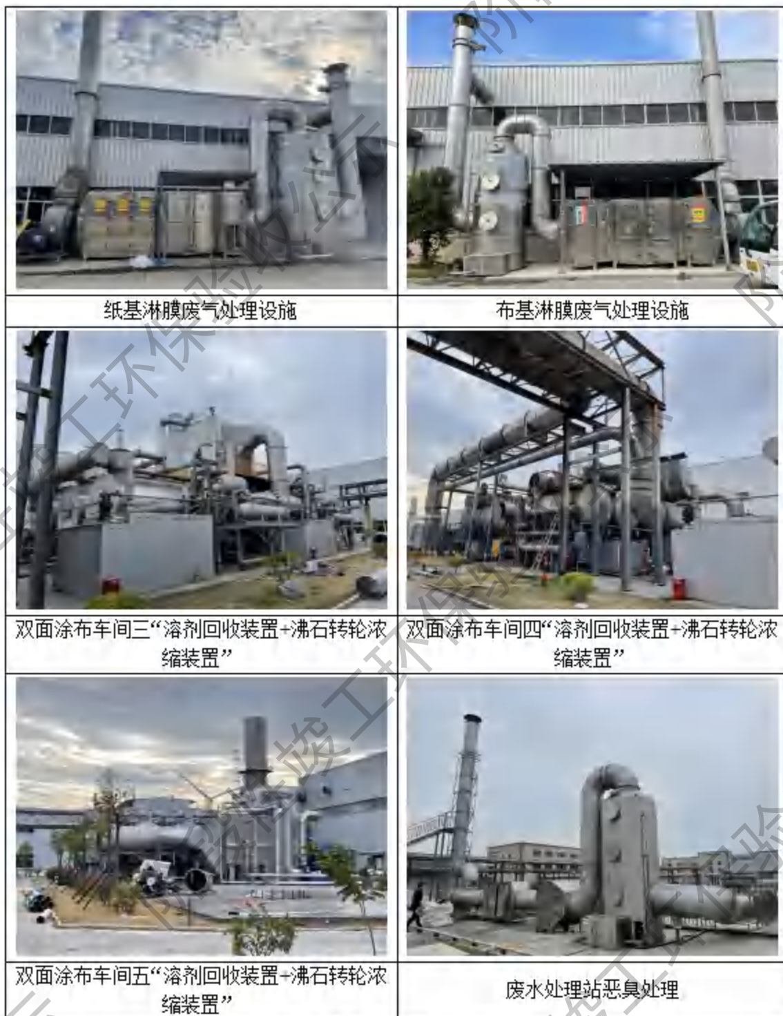
图 4.1-4 有组织废气治理设施
